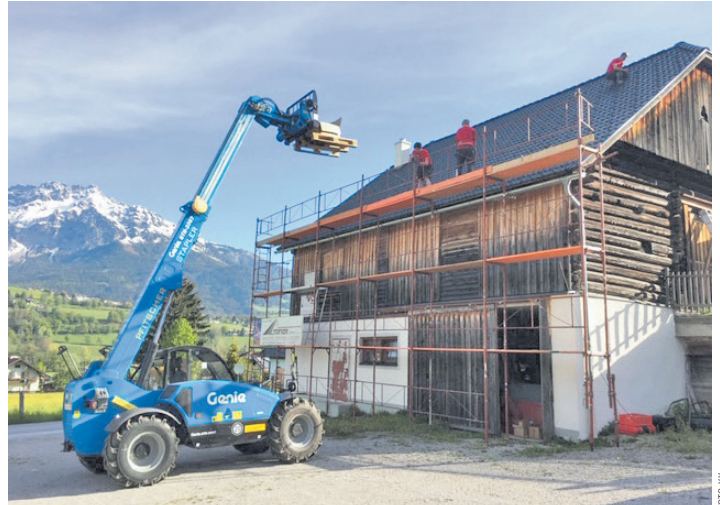
Im Inneren des behutsam sanierten Stallgebäudes befindet sich das Hackschnitzel-Heizwerk, am Dach, farblich abgestimmt, wurde die Fotovoltaikanlage installiert.
