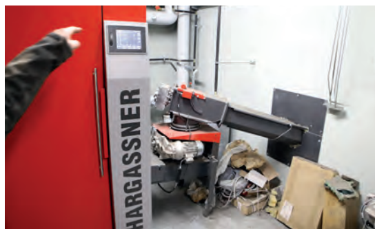
Die Biomasseheizung wird nur bei Bedarf dazugeschaltet.
